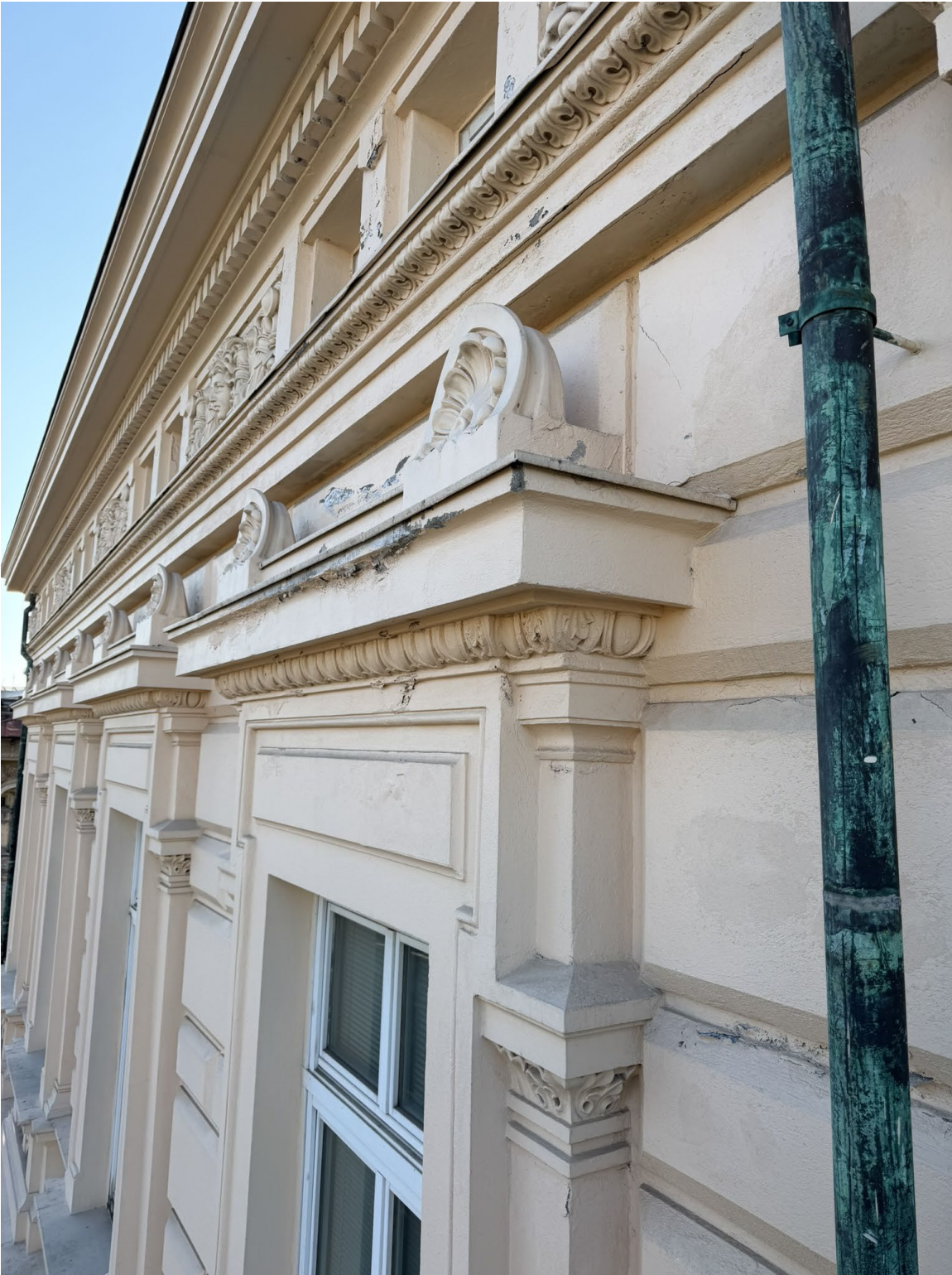
4. Ζημιές επιχρισμάτων στα διακοσμητικά στοιχεία στα γείσα. (Βόρεια Όψη 07/04/2026)
