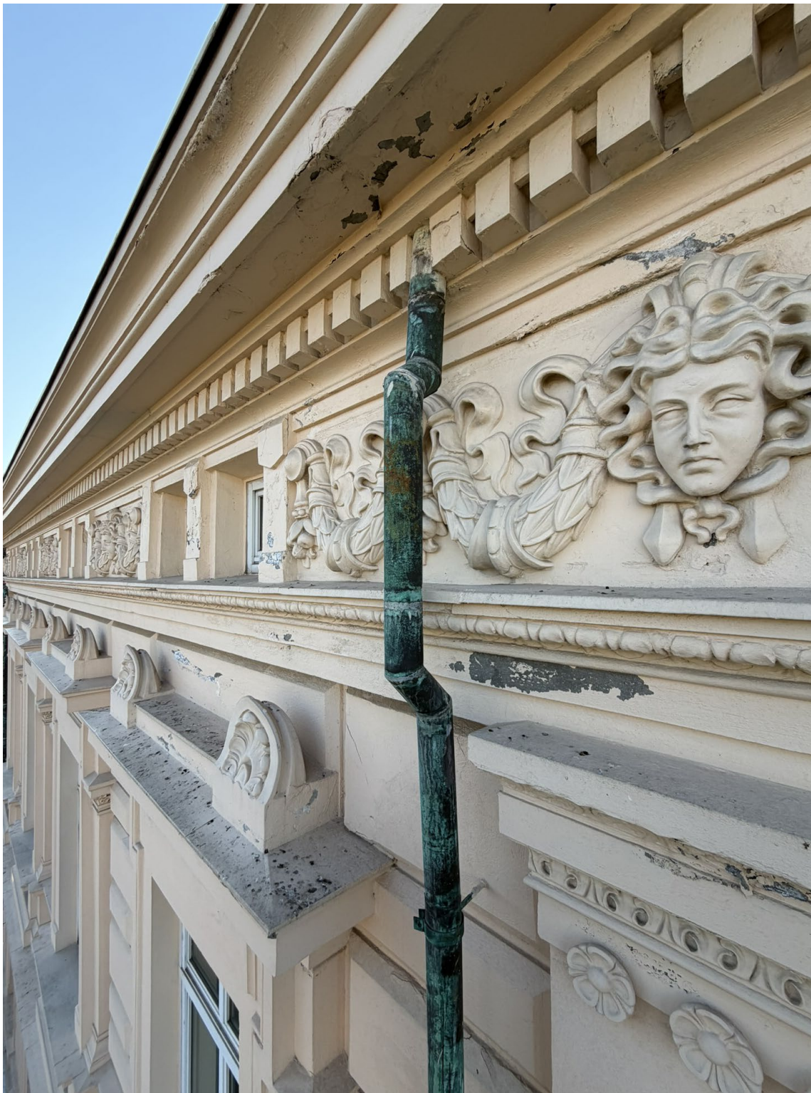
5. Ζημιές επιχρισμάτων στα διακοσμητικά στοιχεία στα γείσα. (Βόρεια Όψη 07/04/2026)
