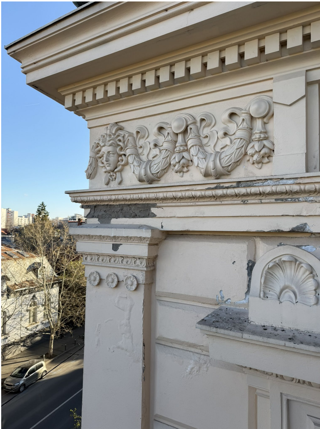
2. Ζημιές επιχρισμάτων στα διακοσμητικά στοιχεία της όψης. Φούσκωμα επιχρίσματος και βαφής από υγρασία. (Βορειο – Βορειο δυτική όψη 07/04/2026)
