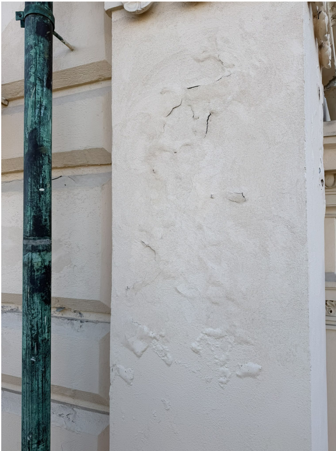
3. Ζημιές επιχρισμάτων στα διακοσμητικά στοιχεία της όψης. Φούσκωμα επιχρίσματος και βαφής από υγρασία. (Βορεια όψη 07/04/2026)
