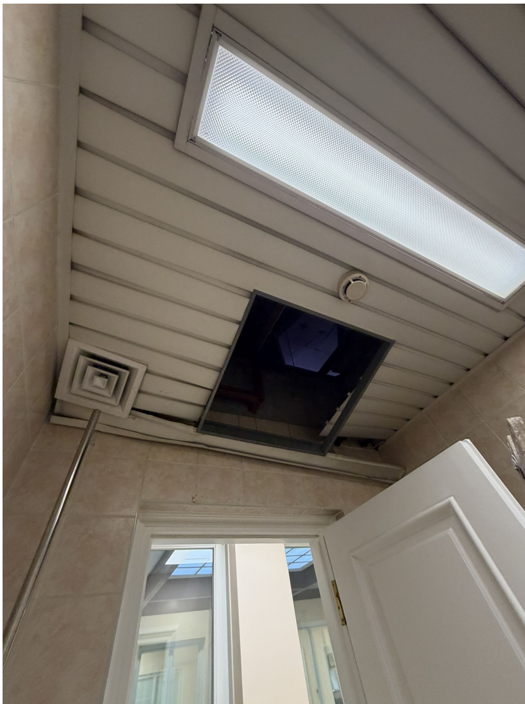
12. Υποχώρηση της Ψευδοροφής (07/04/2026)
