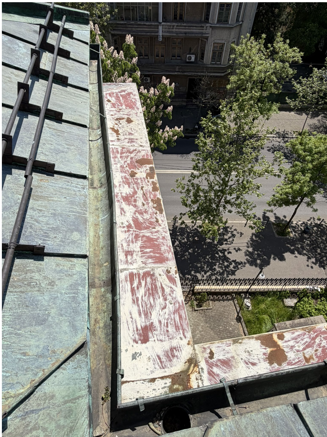
10. Αποκολλημένοι σύνδεσμοι χαλκού που στηρίζουν την υδροροή (07/04/2026)
