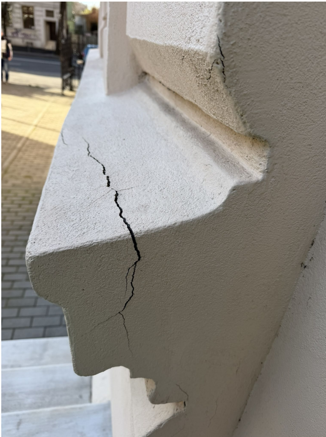
8. Ρηγματωση του διακοσμητικων στοιχειων της κεντρικης εισόδου. (Ανατολική Όψη) 07/04/2026)
